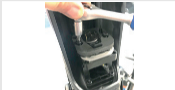
Figura 22: Aflojamiento de los tornillos del soporte del adaptador
